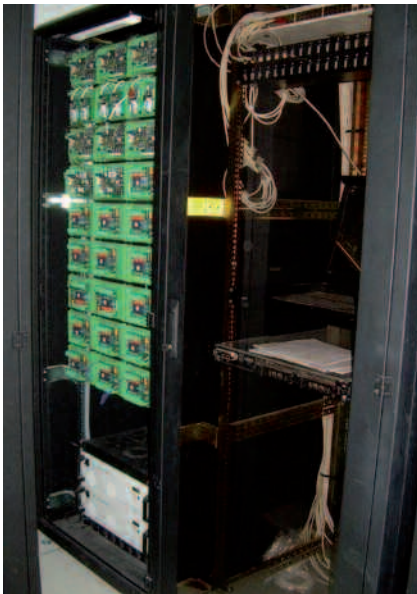
Vue de la baie du contrôle d'accès
