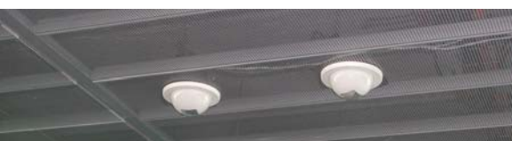
Plus de 100 caméras raccordées au système contrôle d'accès.
